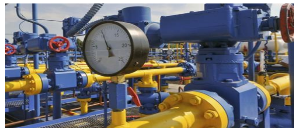
Centrale à gaz de logbaba
